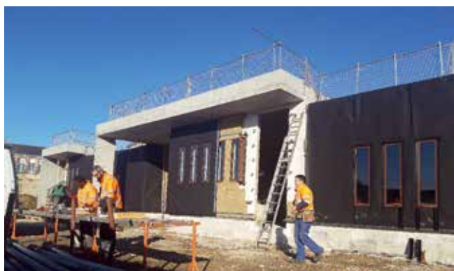
Les travaux avancent rue Alain-Gerbault où les entreprises gorronnaises Foisnet, Belliard et Gorronnaise de jardins sont sollicitées.
